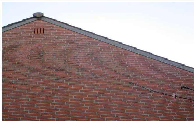
2A Mindre slidskader mørtelfuger på gavlfacade
