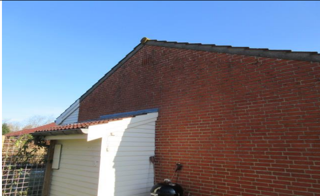
6B Mindre overfladeslid på gavle
