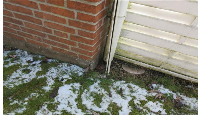
Mindre område med løst sokkelpuds ved hjørne 4A
