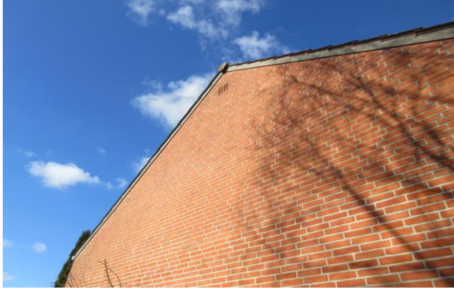
10B Pæn gavlfacade, mindre slid
