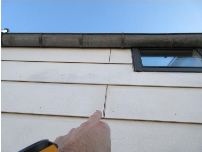
Eksempel revnet fuger beklædning 10A
