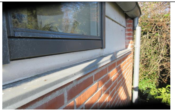
2C Manglende afstand mellem beklædning og sålbænk/inddækningen. Inddækning ses med bagfald. Risiko for øget nedslidning af pladebeklædning pga. fugt.
