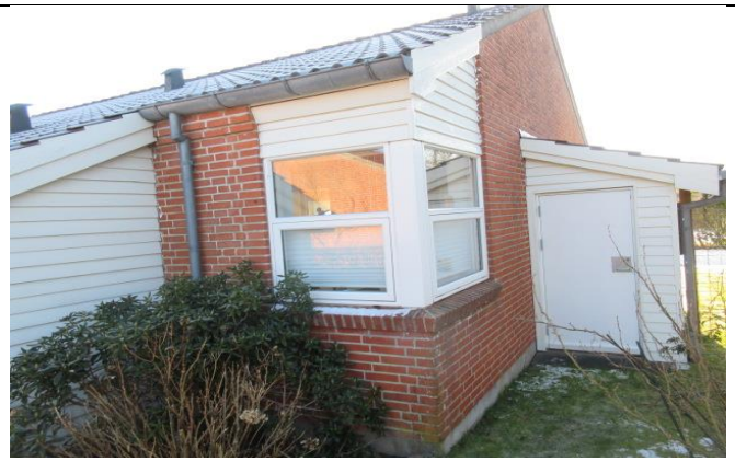
6B Sokkel ved hjørner med mindre opfugtning
