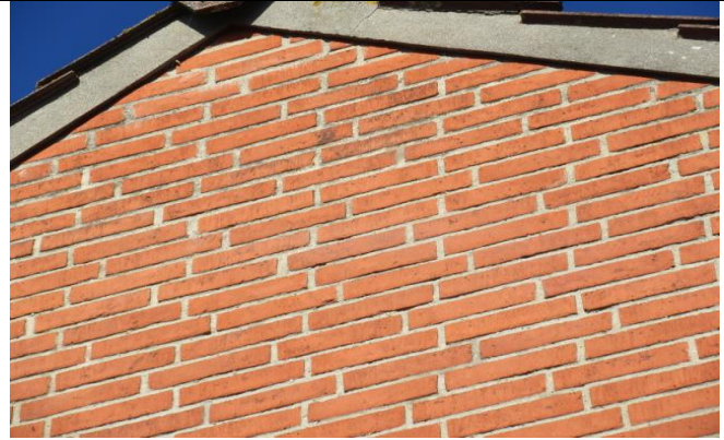
10D Mindre overfladeslid, revne ved pudset bånd
