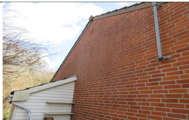
4A Minimalt overfladeslid på gavlfacade
