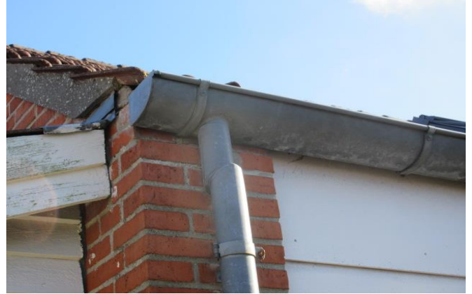
10C Generelt mindre slidskader ved murværket/murpiller op mod tagrender ved gavlafslutninger og mellem bygninger
