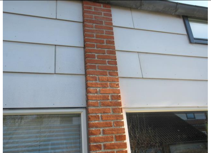
Revnet fuger mod murpille ved 10C/10D
