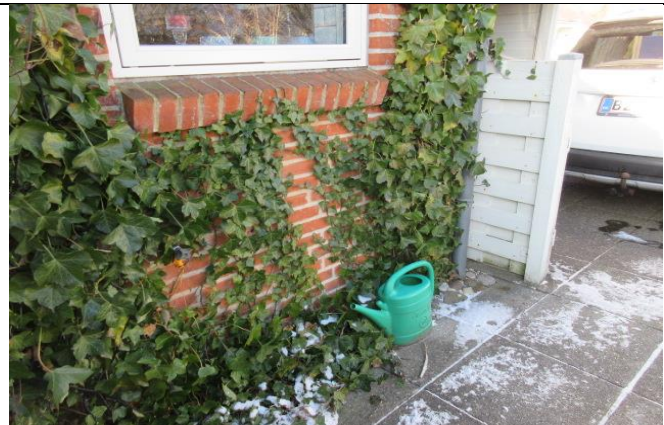
10A Bemærk beplantning medfører unødvendigt overfladeslid på murværk og bør undgås
