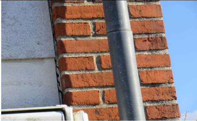
10B Revnet fuger mellem beklædning og mur
