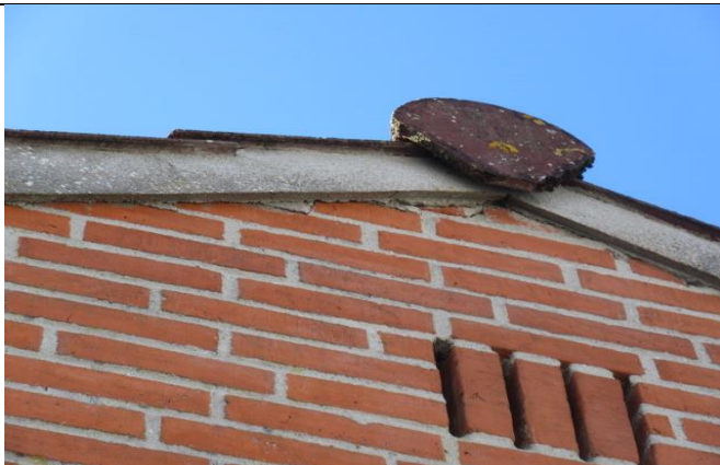
8B Mindre revner ved pudset gesimskant
