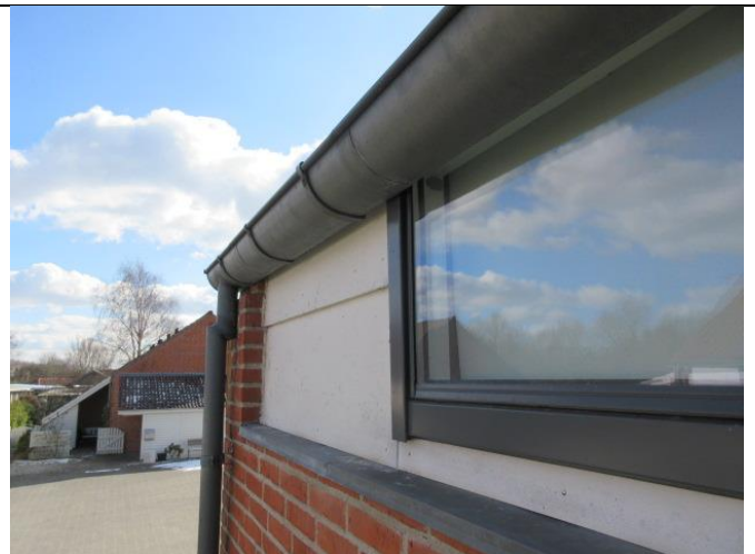
Revnet fuger mod mur eksempel 2D. Mangelfuldt fald ved inddækningen.
