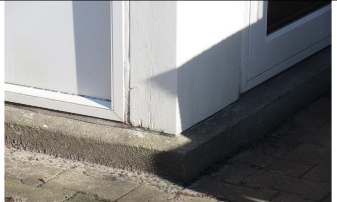
Stolper ved partier i stueplan er flere steder udført med reparationer, disse må forventes vedligeholdt løbende og udføres med reparationer, ses i bl.a. 10B
