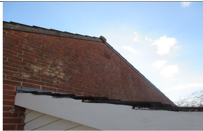
6A Mindre slid overflader på gavl.
