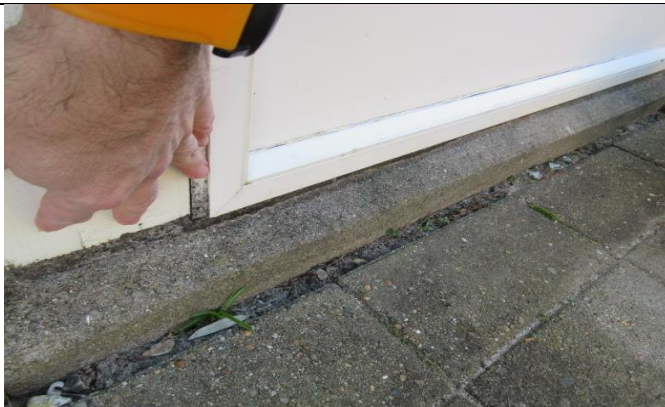
10A Eksempel mindre slidskader ved stolpe.
